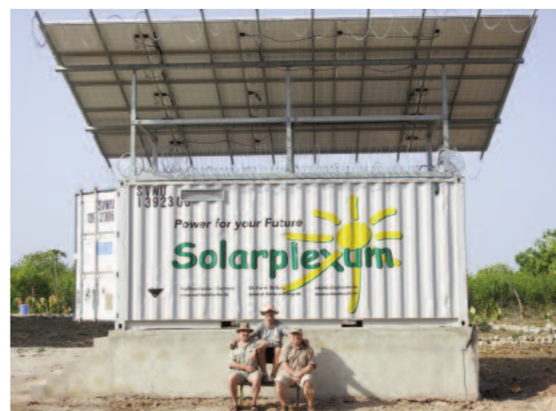
Froh, es geschafft zu haben: Nach drei Tagen Montage unter Afrikas sengender Sonne, nahmen Dr. Korte, L. Robok und Dr. Mehl die in Oberschaben gebaute Solarplexum-Anlage in Betrieb.
